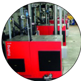
AUSTRIA. Calefacción urbana en Jennersdorf
